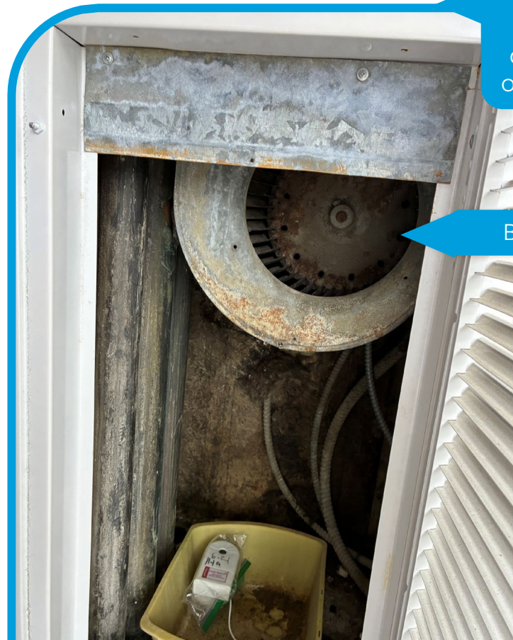
Existing fan coil
